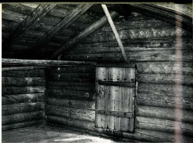
Fig.15. Hårsetstuas loftetasje har i nyere tid fungert som bod, med hylle og rager for oppheng. Den gamle døren ut til svalen har ikke lenger noen funksjon. Foto:GM/Burny Iversen.
