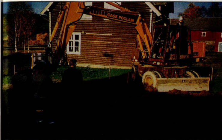
Det er klart for første tak med utgraving av kjelleren under Nystua, snekkerverksted og arkiv.
