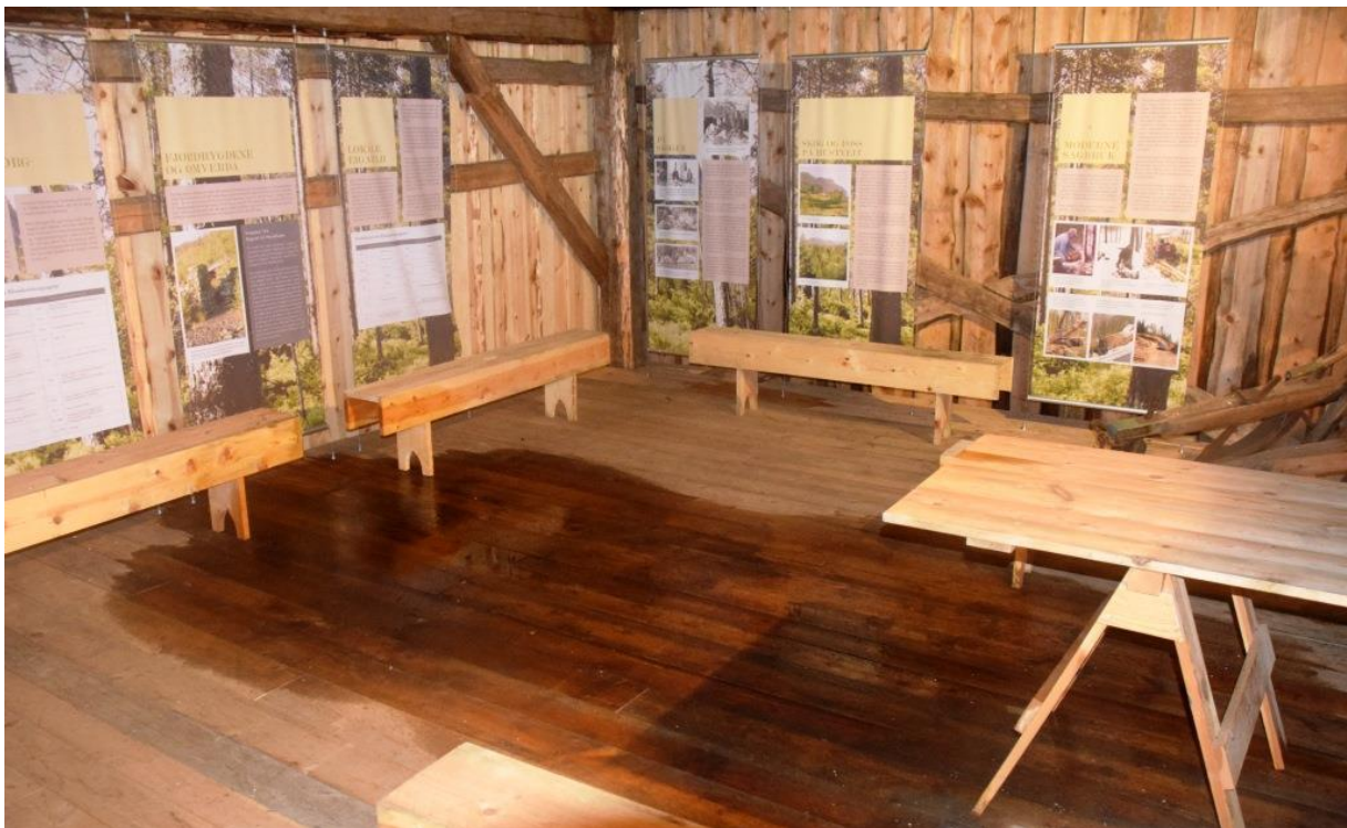
Åtte år etter er det store lekkasjar fleire stader i taket.
