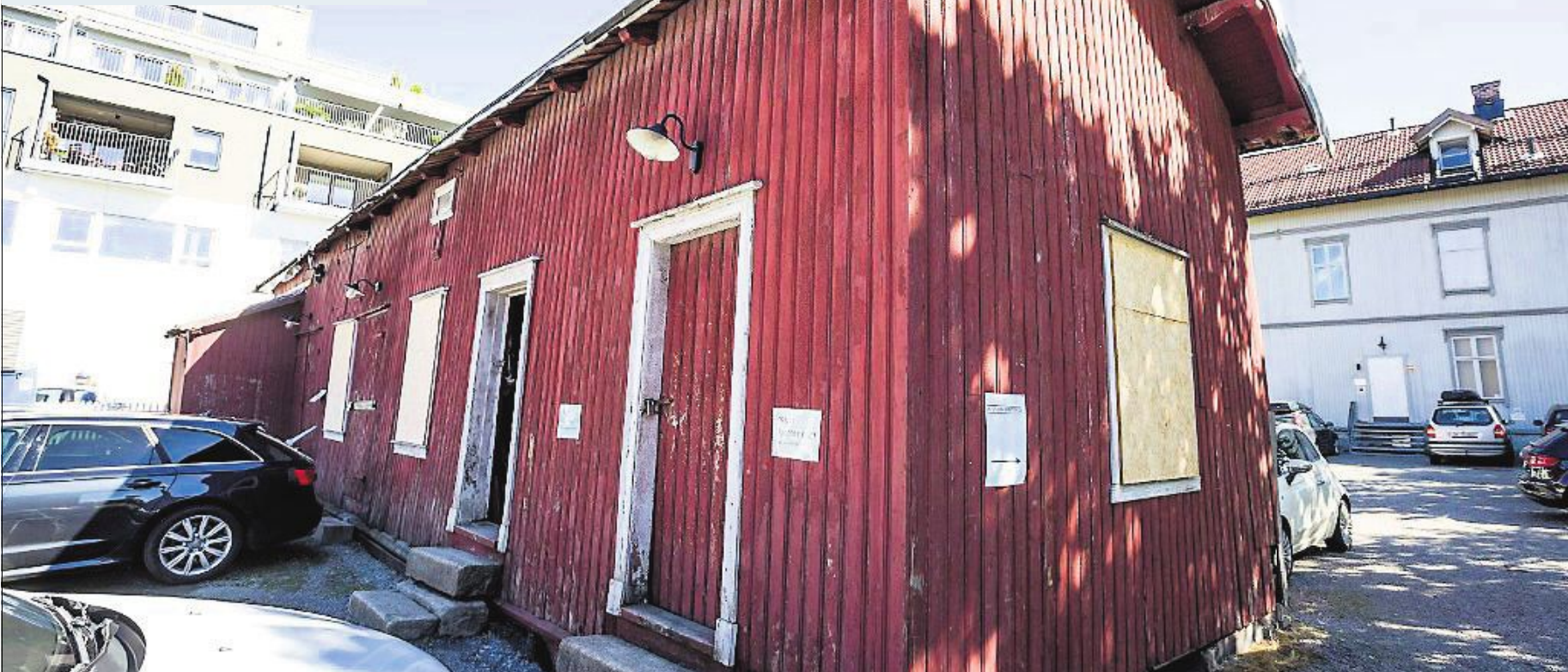
MÅ TÅLE EN VINTER TIL: Uthuset i Kirkegata 2 har vært oppe til politisk behandling flere ganger de siste årene. Selv om det er definert som bevaringsverdig, vedtok politikerne å rive det fordi de syntes det kostet for mye å sette det falleferdige bygget i Kulturkvarialet i stand.
