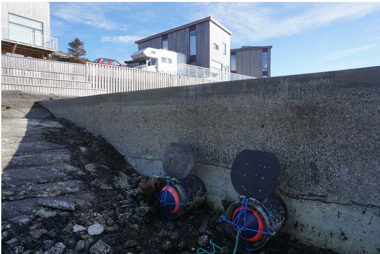
Figur 5 Rør som normalt sørger for utskifting av vann i bukta tettet igjen av bøyer. Foto: S. Wickler/TMU.
