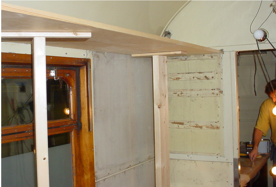
Arbete pågår med inredningen i köksdelarna. Längst till höger Thom Olofsson, fotograferat 2005.
