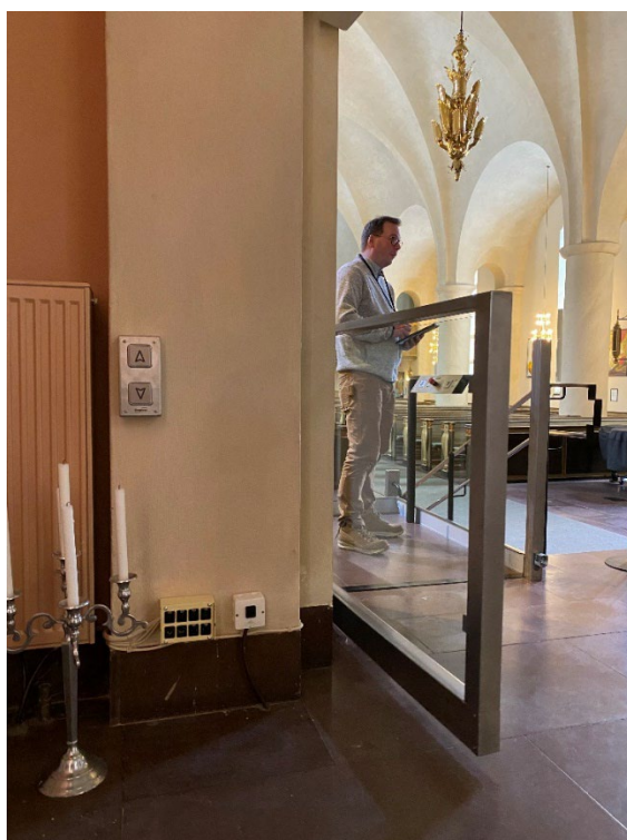
Figur 13. Lyftbordet i korgolvsnivå. Grinden är uppställd. Anropstablån i kornivå är monterad på väggen. Knapptablåns plåt ska bytas till en mässingsplåt. Foto: 2023-02-23.
