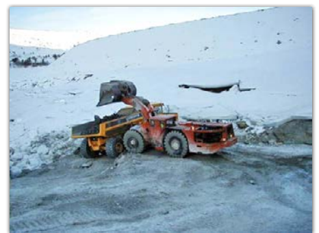
Et sjeldent bilde av maskinen ved arbeid uten-dørs, fra driving forbi raset i omløpstunnelen ved Folsjødammen i 2001. Foto: Terje Bratberg
