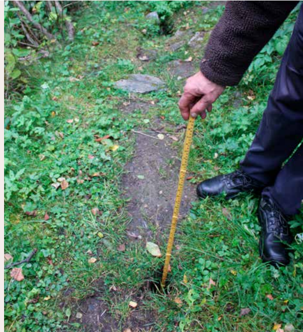
Små hull i vegbanen ved Laukebergbakken skjulte langt større skader. Foto: Jan Adriansen/Statens vegvesen
