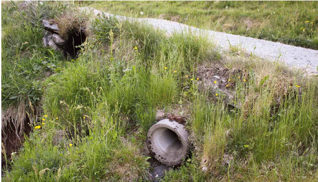
Den steinbygde stikkrenna på postvegen fra slutten av 1700-tallet er her byttet ut med et plastrør og et betongrør. Melingen i Åsane, Bergen kommune, Vestland. Foto: Jan Adriansen/Statens vegvesen
