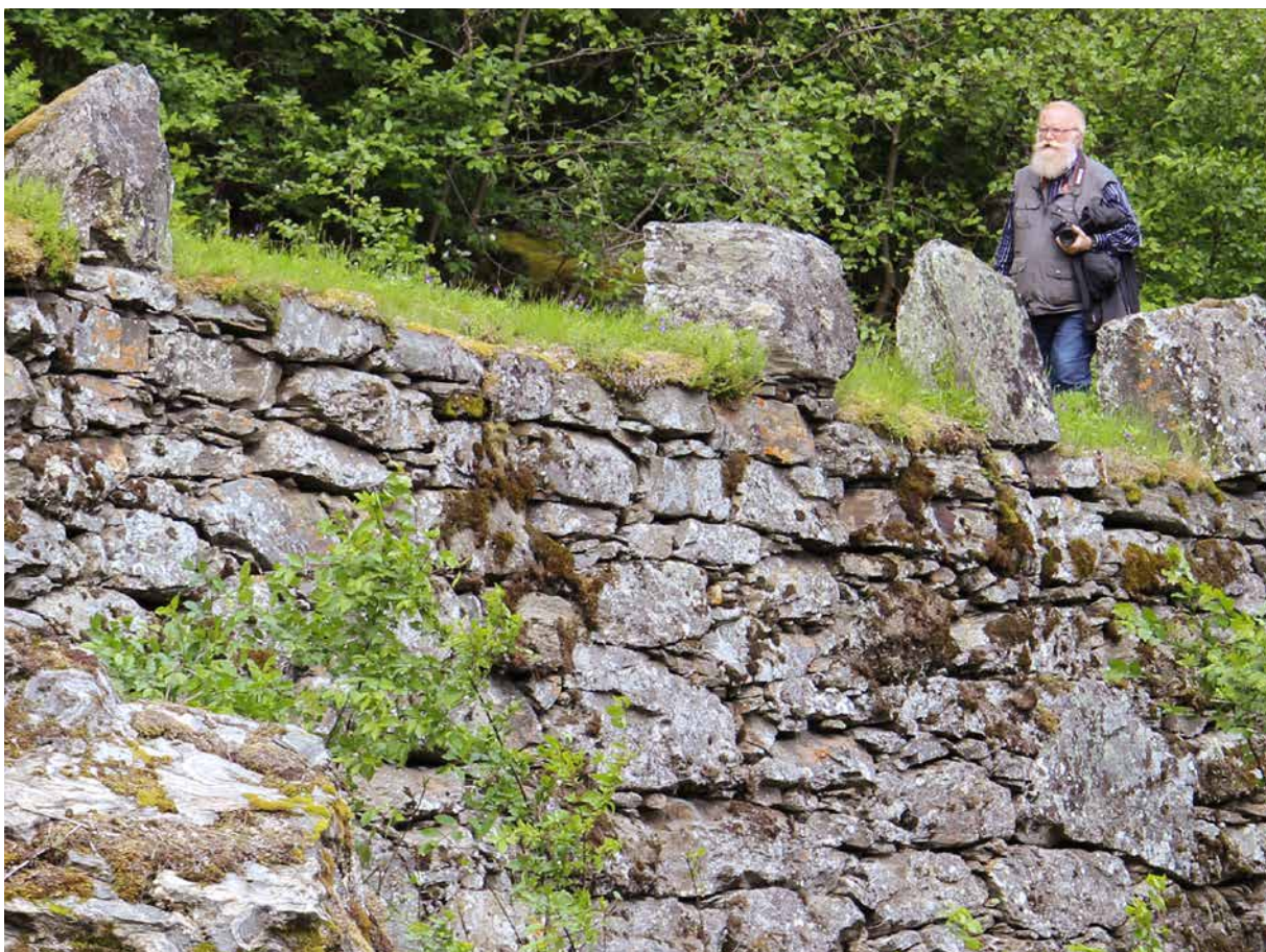
Den bergenske hovedveg ved Borgund i Lærdal kommune, Vestland, ble bygd i 1840-årene, i brytningsfasen før chausséperioden formelt ble innført med vegloven av 1851. Foto: Jan Adriansen/Statens vegvesen
