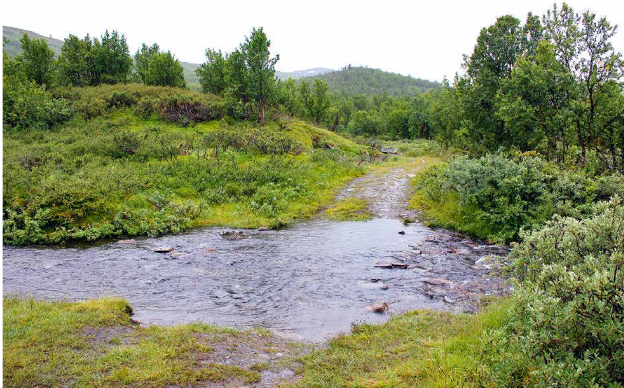
Tette og kollapseste stikkrenner kan føre til oversvømmelser. Vang kommune, Innlandet. Foto: Jan Adriansen/Statens vegvesen
