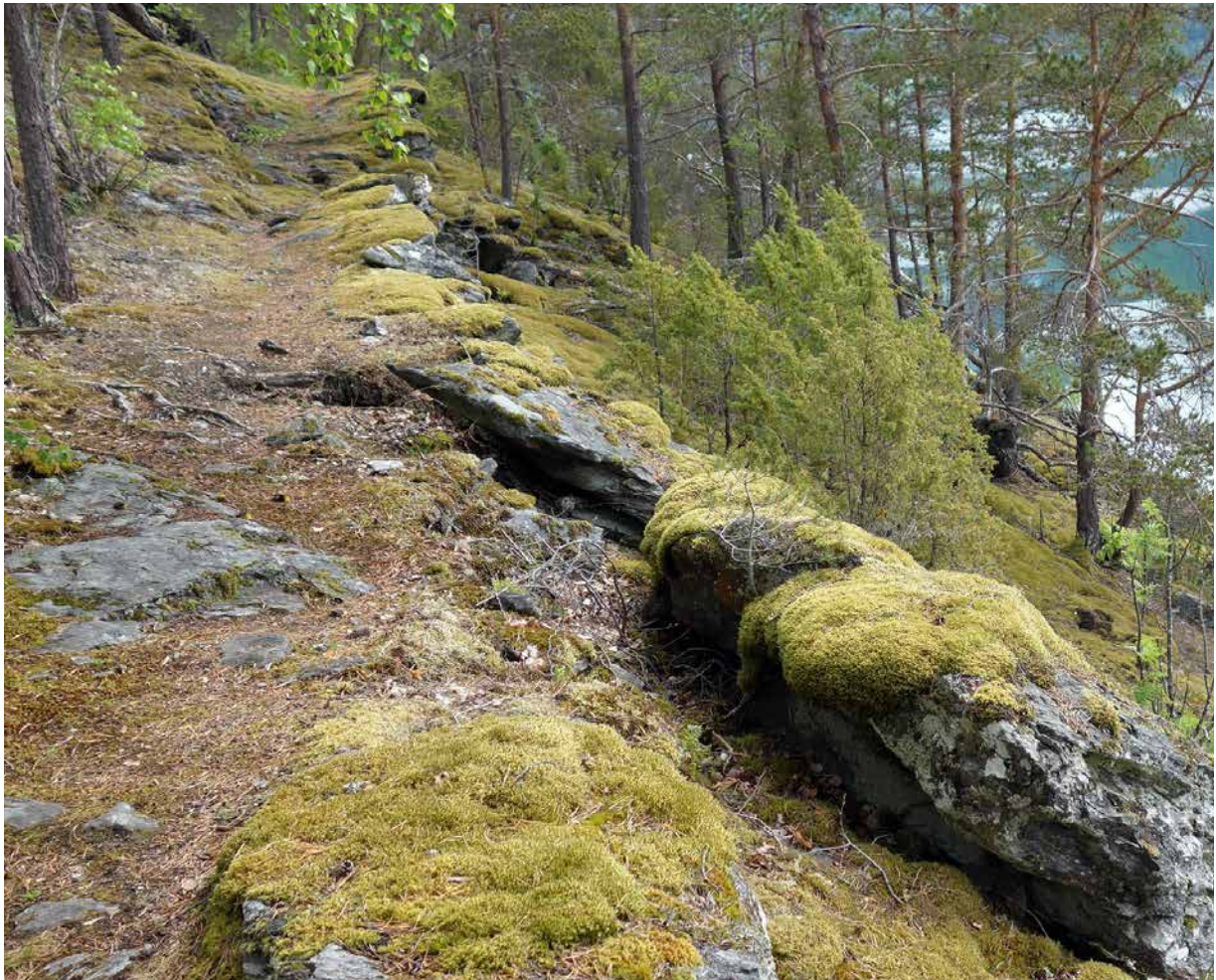
Eksempel på TG2. En vegmur som har sklidd ut, men stabilisert seg. Den bør repareres, men ikke nødvendigvis prioriteres på kort sikt. Man må under registreringen være sikker på at steinene virkelig har stabilisert seg, ellers vil skaden gå over i neste kategori. Her fra ferdsevsvegen i Bargarden i Luster kommune i Vestland. Foto: Liv Byrkjeland/Statens naturoppsyn Luster
