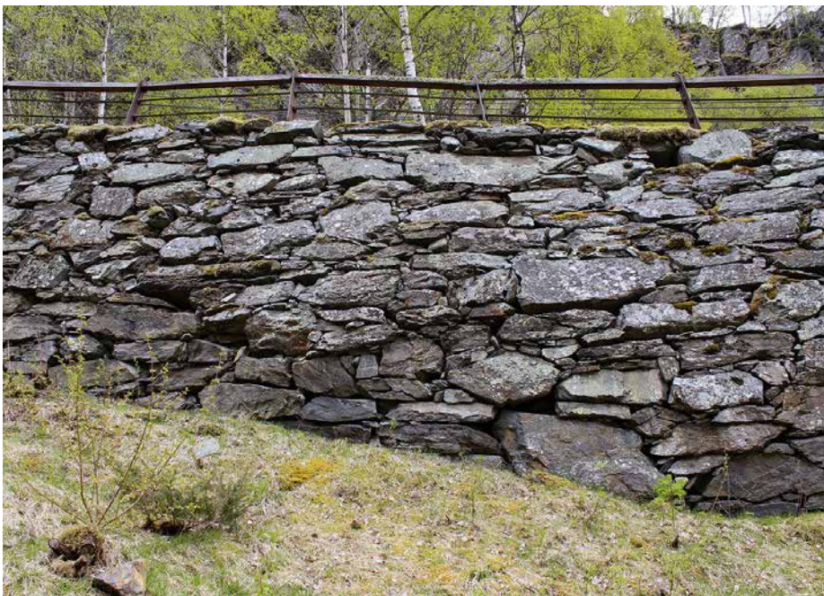
Deler av Vindhellavegen langs Den bergenske hovedveg i Borgund i Lærdal kommune i Vestland hadde begynt å skli ut, og veggen sto i fare for å kollapse. Muren var helt ute av stilling, og hadde på det meste en 120 cm stor «mage». Man kan se på rekkverket at veggen har begynt å sige. Muren er i dag restaurert. Foto: Jan Adriansen/ Statens vegvesen
