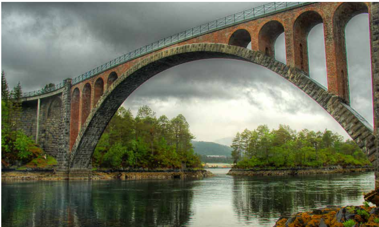
Den 82 meter lange Skodjebrau, eller Storstraumen bru, er Norges største steinhvelvbru bygget for vegtrafikk. Den og søsterbrua Heggjebrau er rene kunstverk i kystlandskapet. Bruene ligger i Skodje kommune i Møre og Romsdal, og åpnet for trafikk i 1919 (offisielt i 1922). Begge bruene er fredet og med i Nasjonal verneplan for vegminner. Det samme er den 110 meter lange tunnelen som skiller dem. Den var Møre og Romsdals første vegtunnel. Foto: Trine Dahl/Wikimedia
