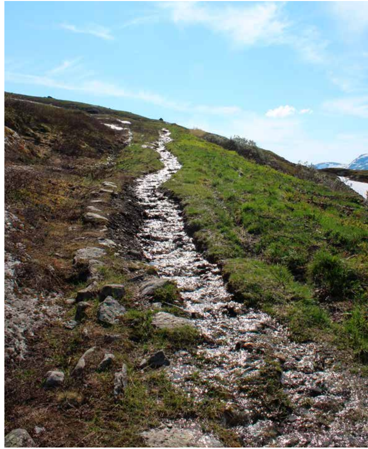
Denne bekken midt i vegen fra 1790-årene skyldes gjengrodde grøfter lenger opp i lia. Den eneste løsningen er å åpne grøftene og stikkrennene. Fra Kongevegen over Filefjell, nær Murklopphøgda, ved grensen mellom Lærdal kommune i Vestland og Vang kommune i Innlandet. Foto: Jan Adriansen/Statens vegvesen
