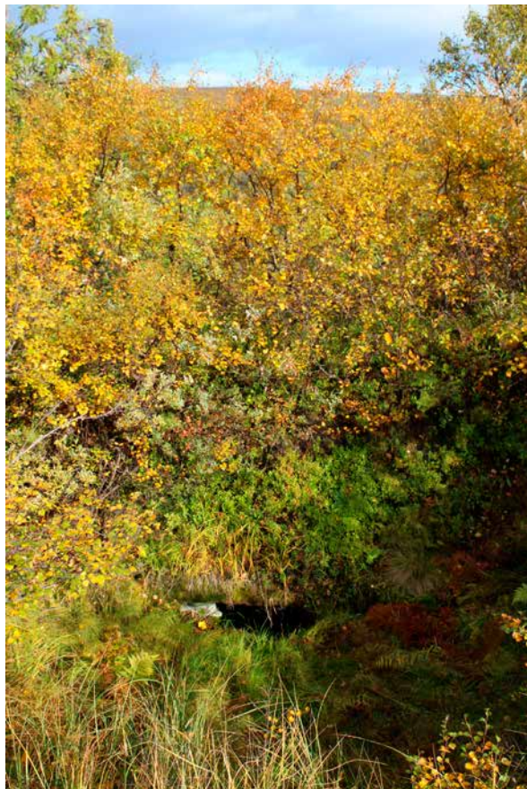
Av og til kan både stikkrennene og vegen ha «gjemt seg». Foto: Jan Adriansen/Sweco
