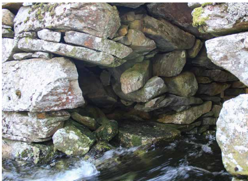
Bruhaugane bru langs Den trondhjemske postvei i Gulen kommune, Vestland, ble bygd så tidlig som i 1788. Flomvann hadde løsnet stein inni et av brukarene, og som bildet viser sto brua i fare for å kollapse. I 2019 ble brua restaurert. Foto: Jan Adriansen/Statens vegvesen
