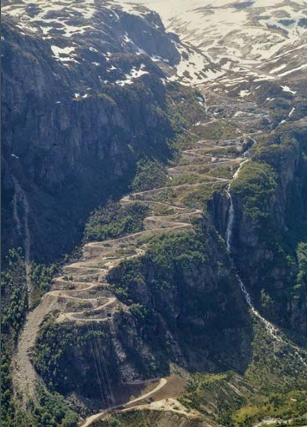
Anleggsveien, den etter hvert så berømte «Lysebotn opp»-veien, var i juni 1982 kjørbart til Stølsdalen, første tverrslag for overføringstunnelen fra Lille Tjodan til Låtervik. (Foto: Thor Berghom)
