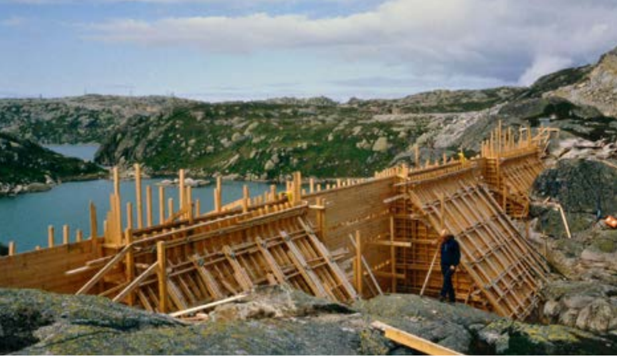
Det var ingen enkel oppgave å få materiale opp til damforskaling (Foto: Thor Berghom)
