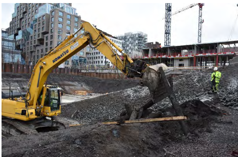
Figur 15: Overvåking av den seksjonsvise gravingen av masser inn mot spuntten. Foto av Marja-Liisa P. Grue, NMM.
