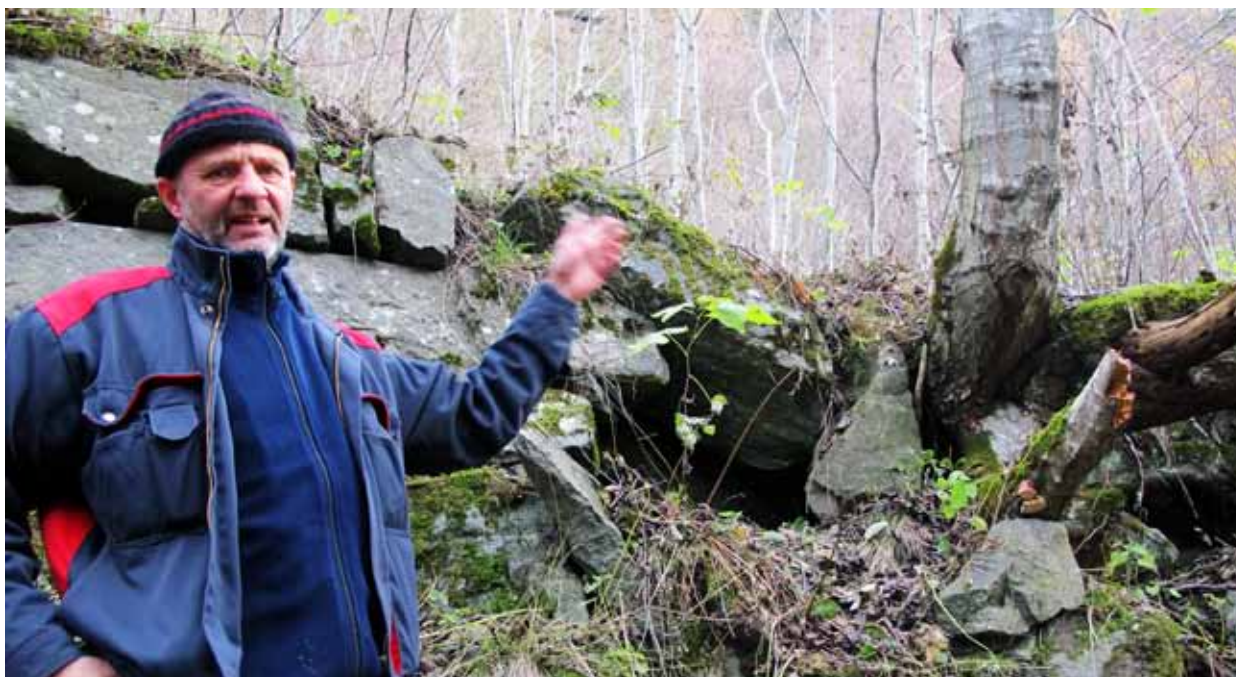
Vegvokter Rune Nicolaysen viser et tre som har vokst inn i muren og sprengt i stykker vegen i Galdane. Dessverre ikke det eneste. (Foto Tine Eikehaug)
