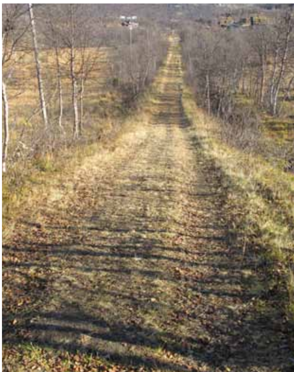
Gjennom Tyinkrysset er store deler av vegen i god stand, men det er mye kantvegetasjon og gjengrodd grøfter. (Foto Tine Eikehaug)
