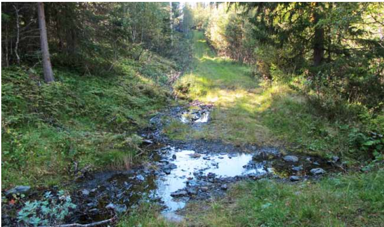
Ved tette grøfter og ødelagte stikkrenner finner vannet nytt løp over veggen. Mellom Varpe og Hermundstad har flere stikkrenner kollapset. (Foto Tine Eikehaug)
