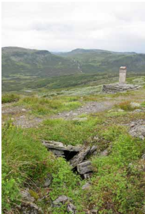
For å få et best mulig resultat er det viktig at man samarbeider om tilrettelegging av Kongevegen over fylkesgrensen. Kollapset stikkrenne ved stiftsstøtten på Filefjell. (Foto Hanne Johnsrud)
