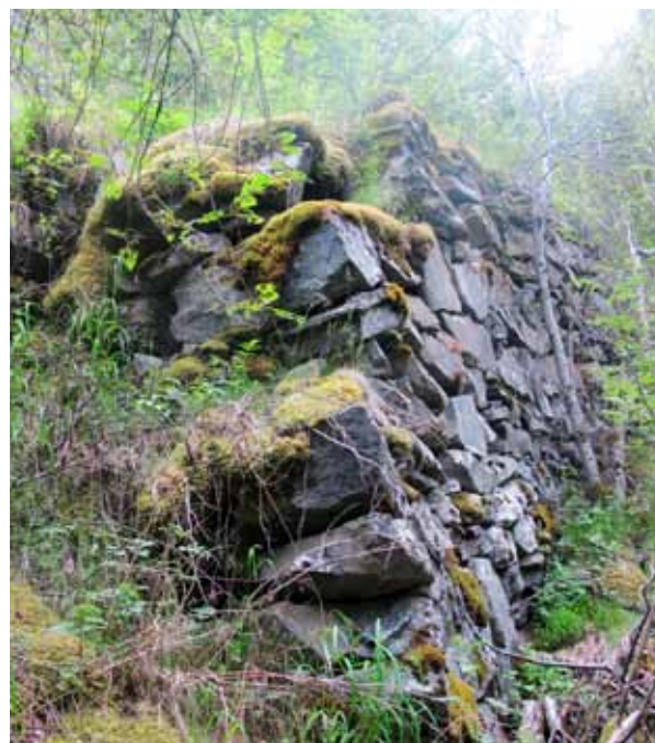
Flere steder, som her i Laukeberggalden, har deler av veggen rast ned de bratte fjellsidene. (Foto Jan Adriansen)
