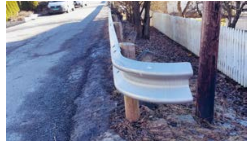
Rekkverksende det er livsfarlig å kjøre inn i. Nedenfor, et eksempel på en livsfarlig nedført rekkverksende (Foto: Arnulf Ingulstad)
