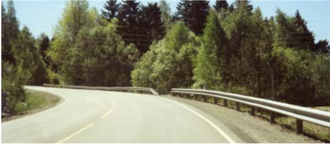
Eksempel på en farlig plassering av en nedført rekkverksende i sving. (Foto: Arnulf Ingulstad)
