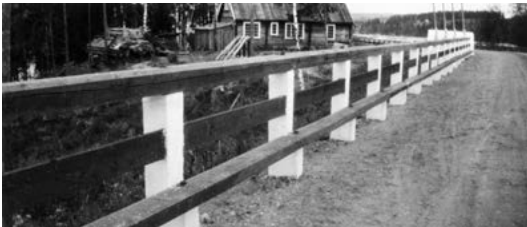
Rekkverk med gjennomgående planke i støpte stolper, i bruk like ved Bingsfoss bru i Akershus. (Foto fra "Meddelelser fra Veidirektøren", 1930)
